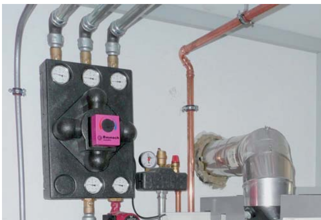
Rendemix-Gruppe zur Rücklaufanhebung des Holzheizkessels und optimalen Schichtung des Pufferspeichers
