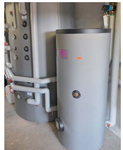
Das Trinkwasser wird wegen des hohen kurzzeitigen Bedarfs für den Milchbetrieb und die Reinigungen in einem 400-Liter-Speicher vorgehalten. Er hat eine untere und eine obere Einspeicherstelle und kann parallel zu den Heizkreisen versorgt werden. Die obere heiße Zone laden der Holzessel oder der Puffer auf, der untere Wärmetauscher wird direkt von der Solaranlage angefahren. Die Entnahmetemperatur beträgt im Minimum 60 °C
