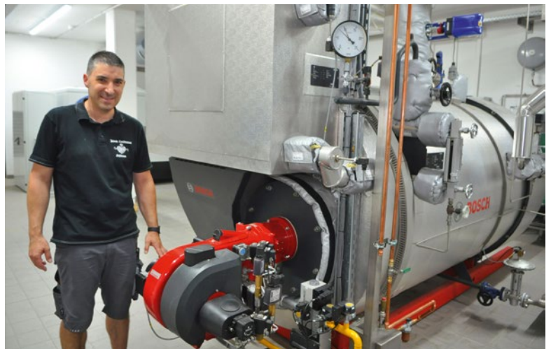
▲ Die erdgasbetriebenen Dampfkessel haben eine Feuerungsleistung von je 1 MW.
