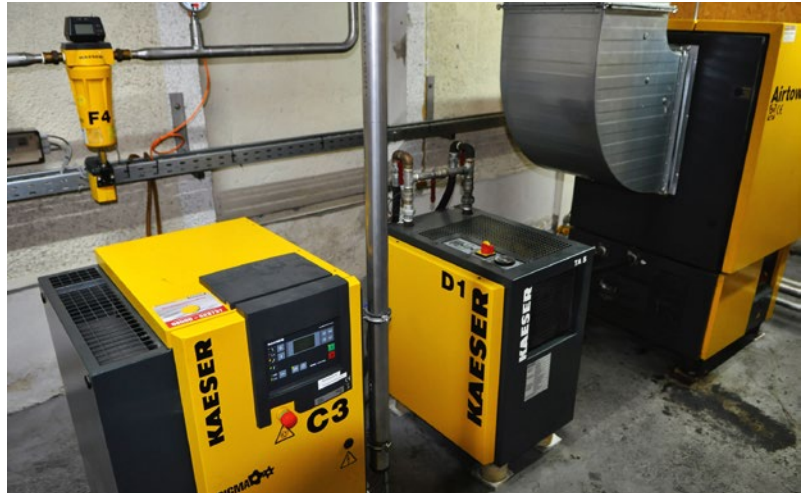
▲ Schönram rüstet auf moderne Druckluftherzeuger (im Vordergrund) um. Die Geräte liefern etwa 3 Kubikmeter pro Minute. Die Schraubenkompressoren beliefern den Sterilluftbereich, produzieren die Prozessluft zur Automation, zum Schalten von Ventilen und anderes.
