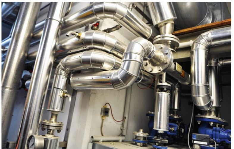
▲ Drallrohr-Wärmetauscher (Spirax Sarco) zur Erzeugung der Höchsttemperatur im Pufferbehälter. Die im Rohrbündel integrierten Drallrohre gestatten eine hohe Spreizung. Die heißeste Temperatur liefert der Brüden der Kondensat-Rückspeiseanlage.
